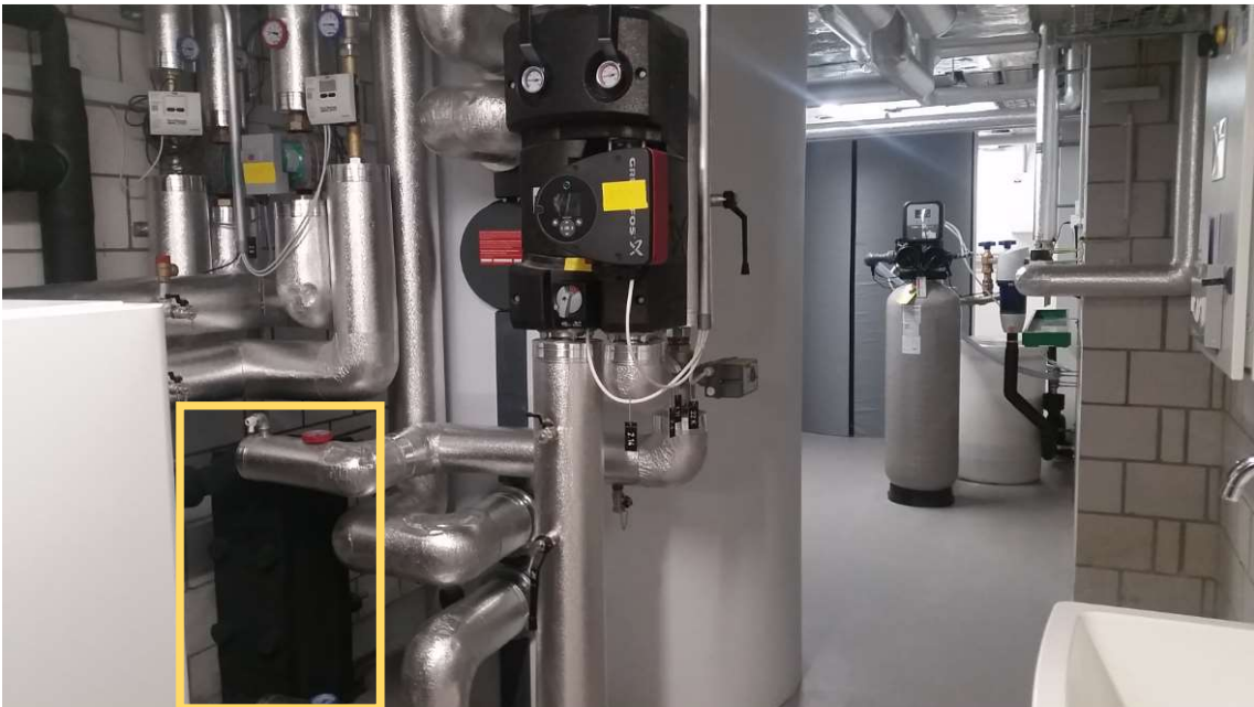
Abbildung 12: Vordergrund: Wärmepumpe mit Heizkreis und Wärmetauscher für «Natural Cooling» über Sonde (eingerahmt), Mitte: Pufferreservoir für Heizung, Hintergrund: Speicher für Brauchwarmwasser (Quelle: Smart Energy Control)
