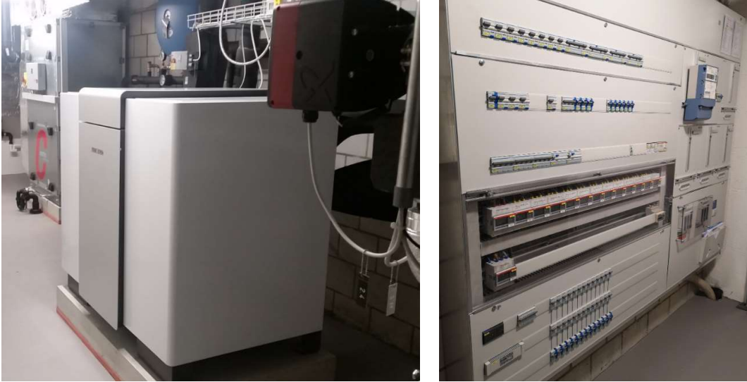
Abbildung 11: Links: Stiebel-Eltron Wärmepumpe für ein Gebäude und kontrollierte Lüftung (Hintergrund), Rechts: Installation der privaten Stromzähler für die einzelnen Wohnungen, Disporäume und Verbraucher (Quelle: Smart Energy Control)
