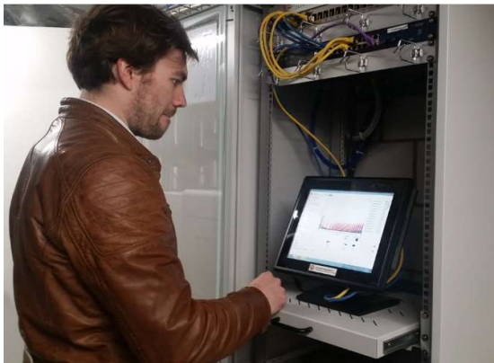
Abbildung 10: Industrie-PC mit Eigenverbrauchsmanager-Software zur Steuerung aller Verbraucher in einem Gebäude (Quelle: Smart Energy Control)
