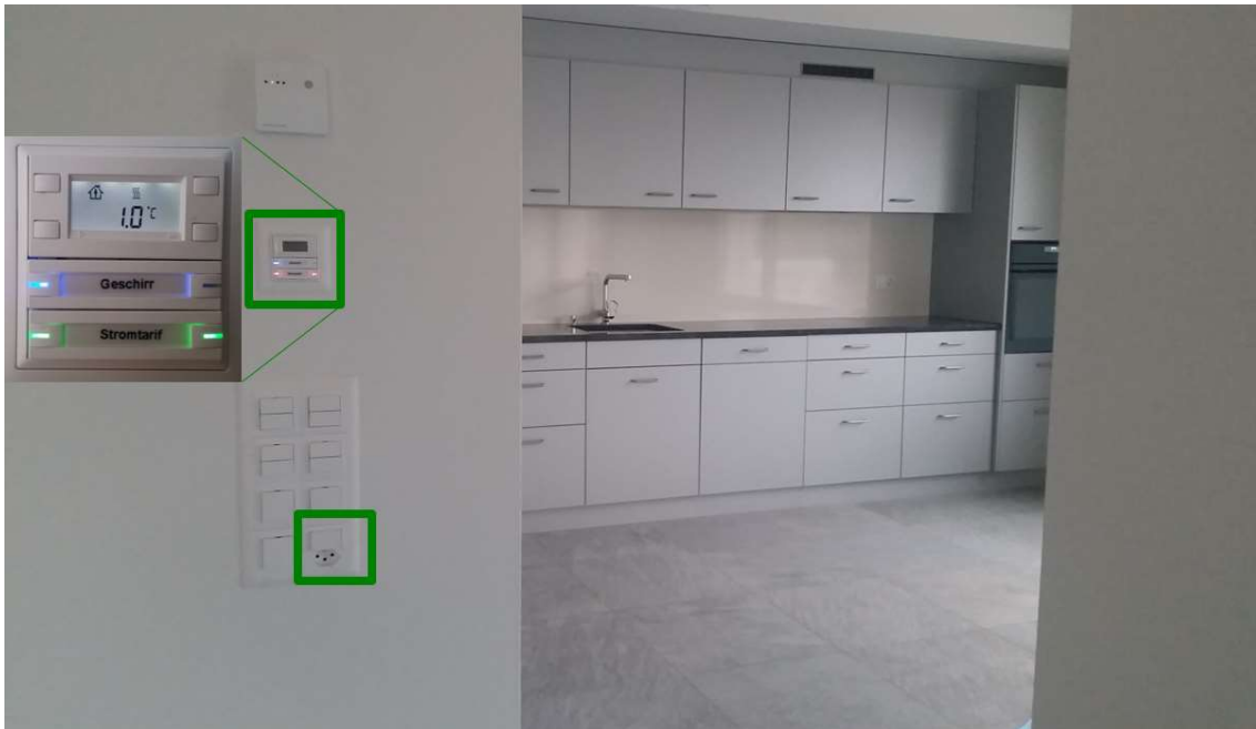
Abbildung 7: Ausrüstung der Wohnungen mit KNX: Temperaturüberwachung, Solarbetrieb für Geschirrspüler, Anzeige Stromtarif, Solarsteckdose (Quelle: Smart Energy Engineering)
