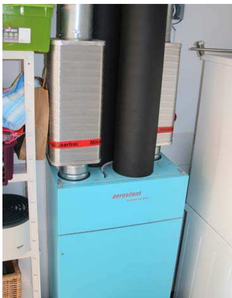
Pro Wohnung ist ein solches Lüftungsgerät installiert: aerosilent von drexel und weiss (Gasser Passivhaustechnik). Über dem Gerät: zwei mineralfaserfreie Schalldämpfer.
